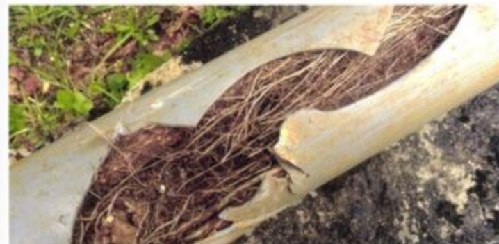
Manchmal werden die Wurzeln im Abwasserrohr in einem Labor untersucht. Das macht man, um festzustellen, welcher Baum das Rohr verstopft hat.
